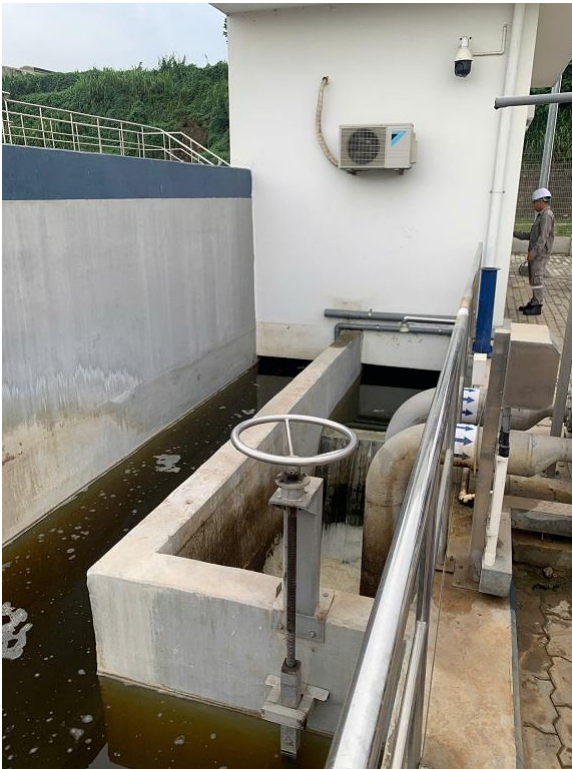
Bể khử trùng
