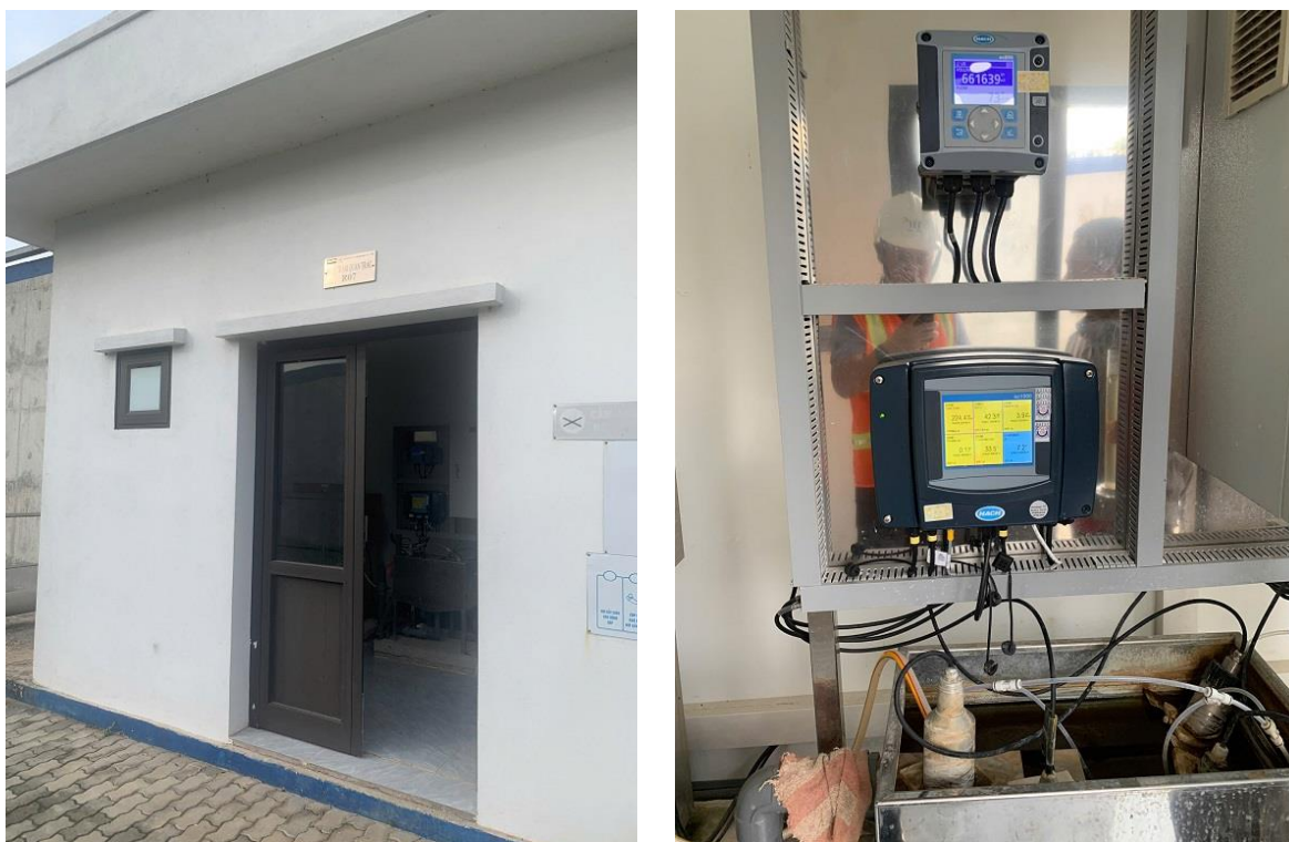
Hình 3. 10. Trạm quan trắc tự động tại Trạm XLNT số 02
