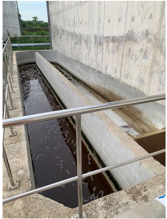
Bể khử trùng
