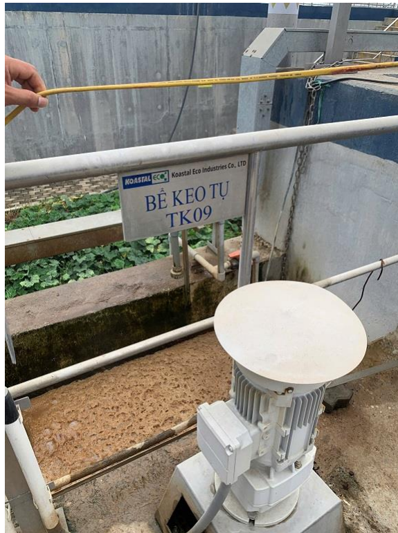
Bể keo tụ
