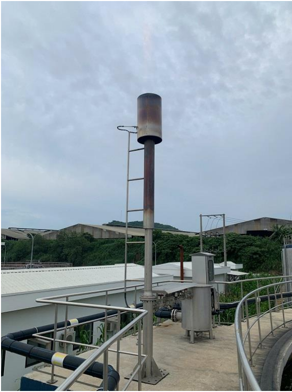
Đầu đốt khí biogas
