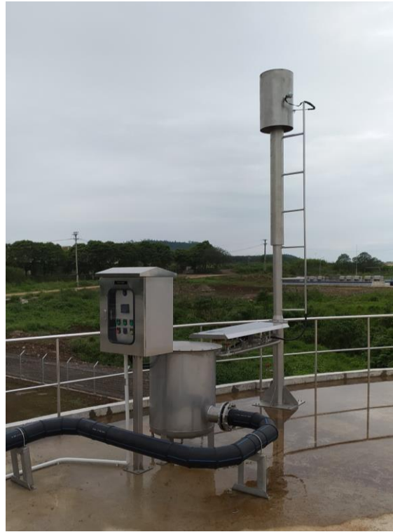
Đầu đốt khí biogas
