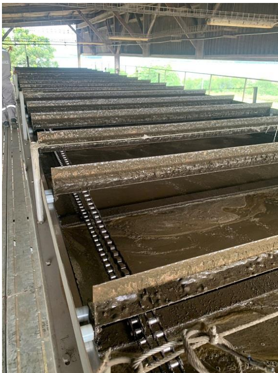
Bể tuyển nổi 1
