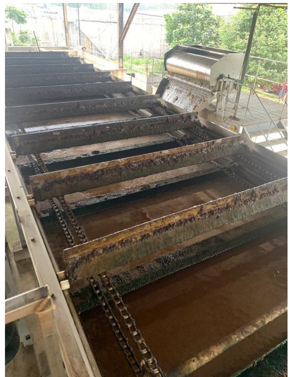
Bể tuyển nổi 2
