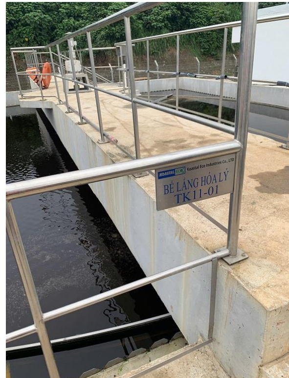
Bể lắng hóa lý
